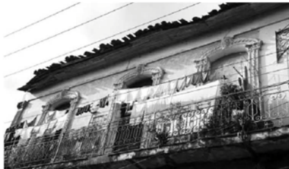
El deterioro de los aleros pone en riesgo elementos identitarios de la villa.
